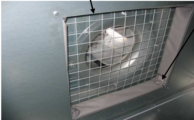
Bild 5.1: Flexibler Segeltuchstutzen am Lufteintritt des Ventilators
