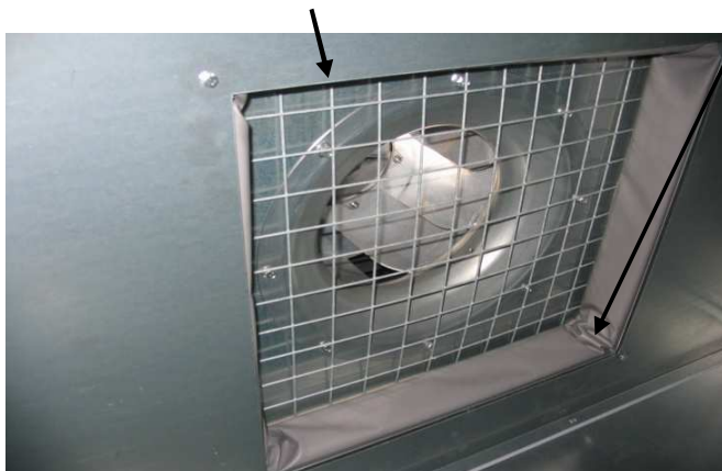
Bild 5.1: Flexibler Segeltuchstutzen am Lufteintritt des Ventilators
