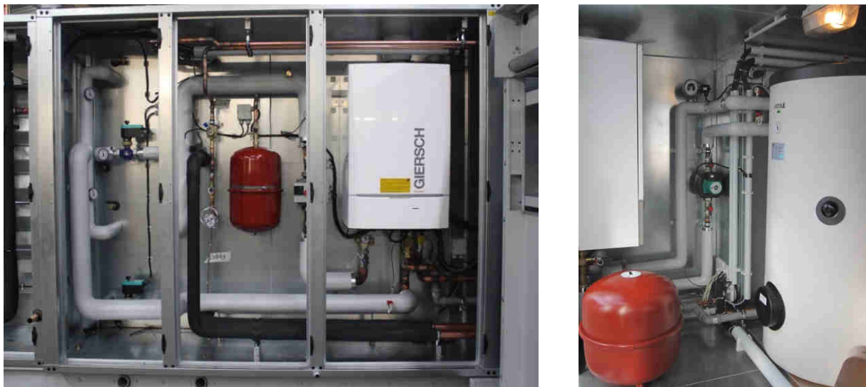
Bild 2.6: Darstellung der integrierten Brennwerttherme und des Warmwasserspeichers
